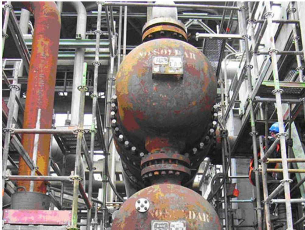
Figura 7. Equipo de hidrocracking
