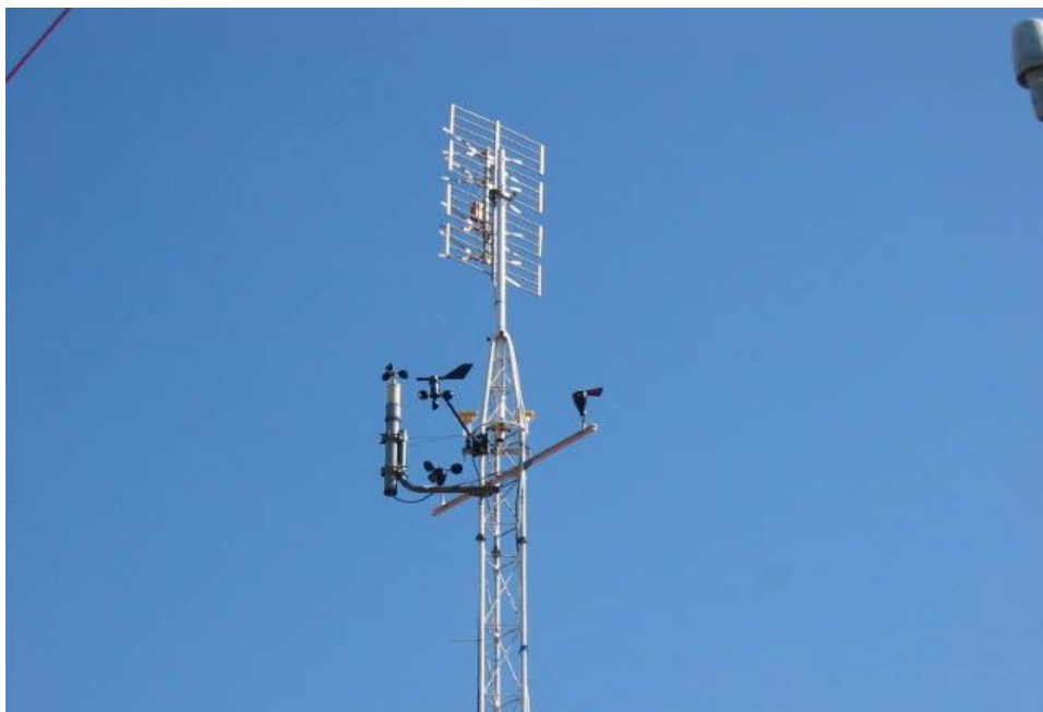
Figura 9. Medición de Velocidad y Dirección del Viento (Anemómetro)
