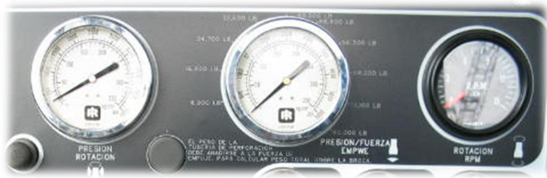
Figura 50. Manómetros de presiones de rotación, avance y tacómetro de barra
