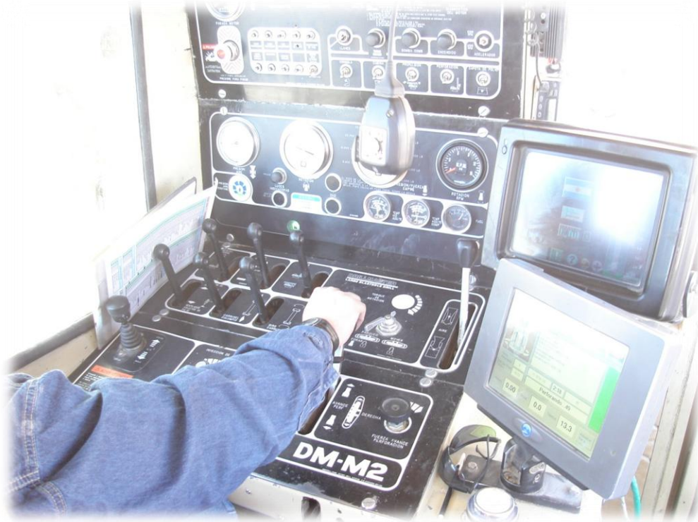
Figura 60. Tablero de cabina de control
