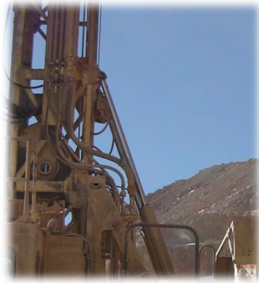
Figura 70. Cilindros de levantamiento de torre
