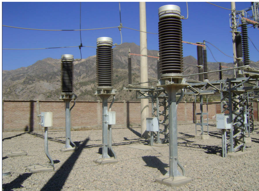
Figura 2.13 Transformador de potencial para 115 kV
